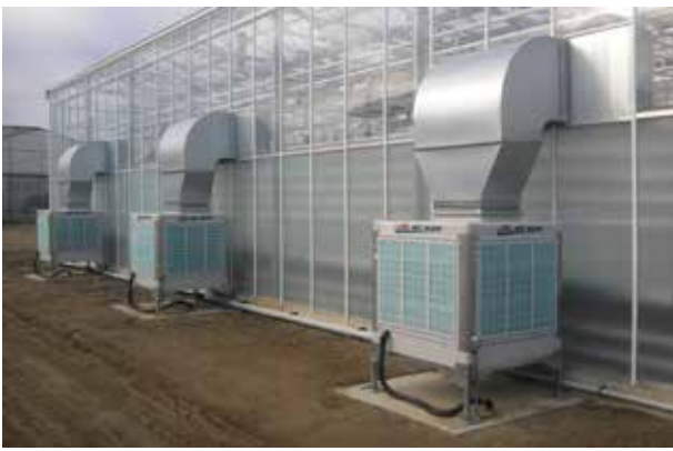
Instalación AD- 15-VS en invernadero
