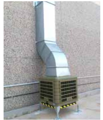
EC-18-VS instalado en pádel indoor
