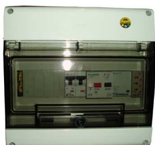
Cuadro de potencia
