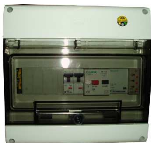
Cuadro de potencia
