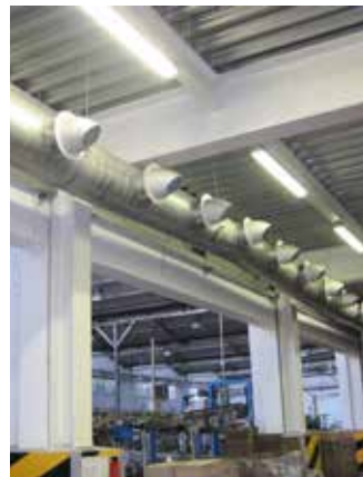
CI-300 Boca de impulsión
