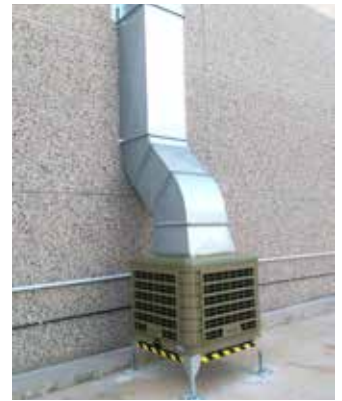
EC-18-VS instalado en pádel indoor
