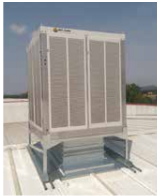
AD- 40-V en nave industrial
