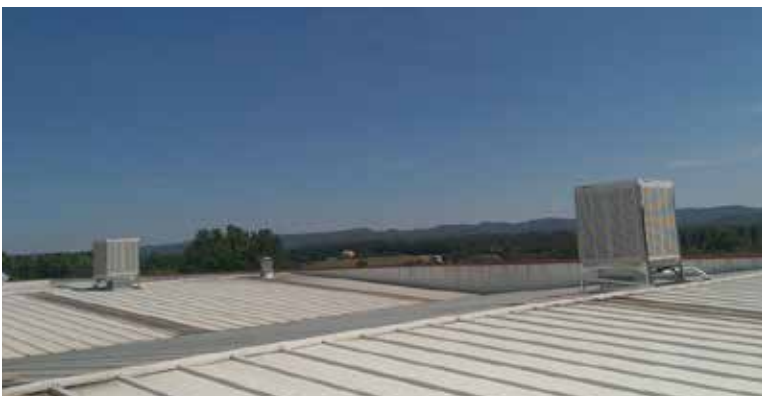
Instalación AD-40-V en el techo de una nave industrial
