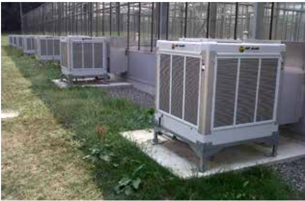
Instalación AD-15-H en un invernadero
